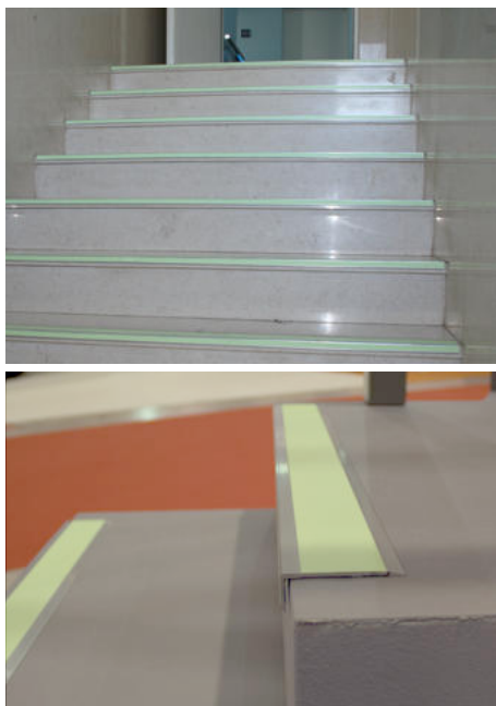
Proteção de degraus
